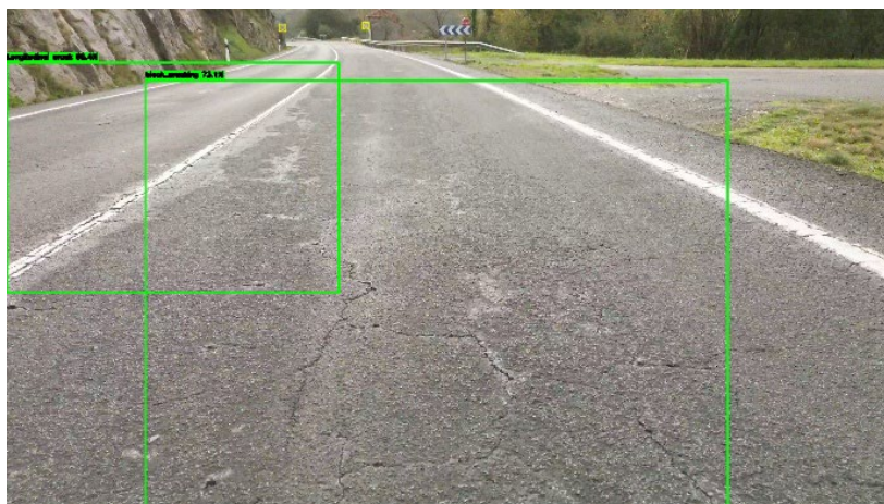
Figura 5. Ejemplo de detección automática de defectos mediante modelos YOLO
