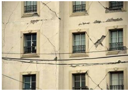
Figura 2. Fachada con grietas
