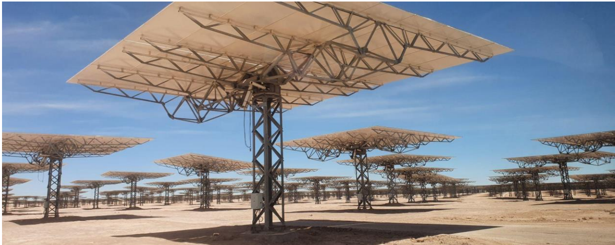
Paneles solares en Cerro Dominador // Fundación Imagen de Chile
